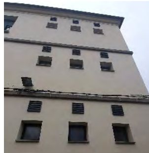
Detalle de las entradas y salidas del aire de la ventilación forzada, por plantas
