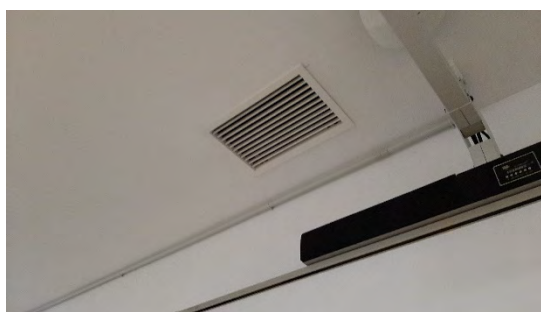
Rejilla del sistema de ventilación forzada (40x25cm)
