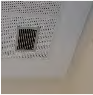
Detalle de la rejilla de extracción (20x40cm)
